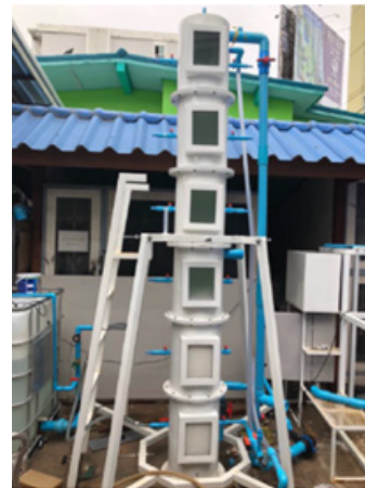
ต้นแบบอุตสาหกรรมระบบ Anaerobic Moving Bed Biofilm Reactor (AnMBBR)
